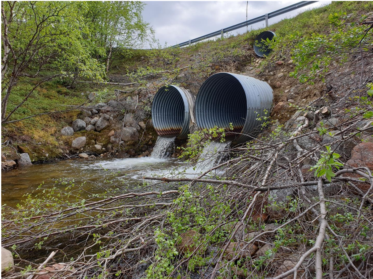
Kulvertene E6 hindrer videre oppvandring for lakseparr i Dordnejohka ovenfor Levajok. Bekken er bratt på oversiden og kulvertene er derfor kategorisert som et vandringshinder uten utbedringspotensiale (foto: Jørn Stefan Opdahl, Statens veivesen).
