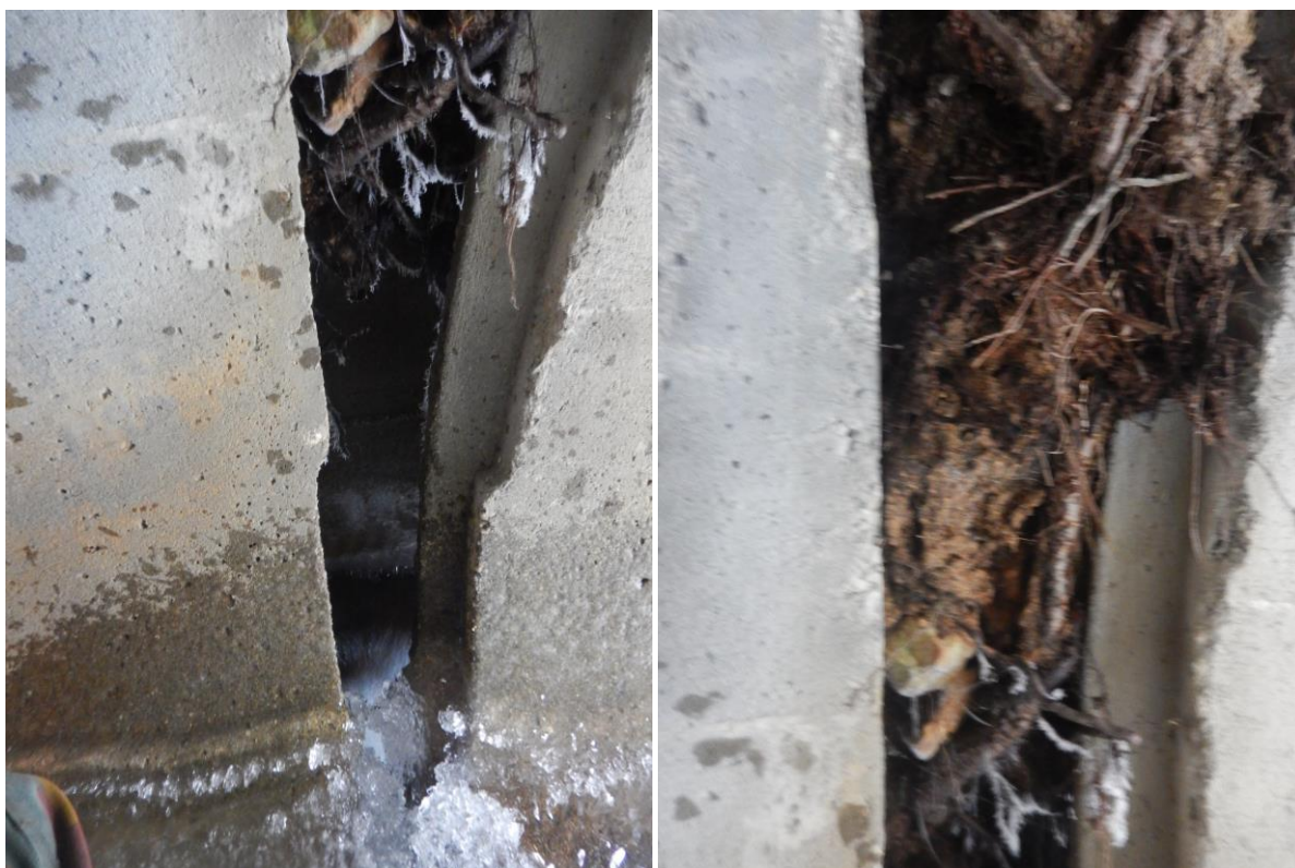
Bilde 4, tatt inni rørkulvert i Raítejoika viser slitasjer som kan tilsi et behov for veiteknisk tiltak som med fordel kan kombineres med en utbedring av vandringshinder.
