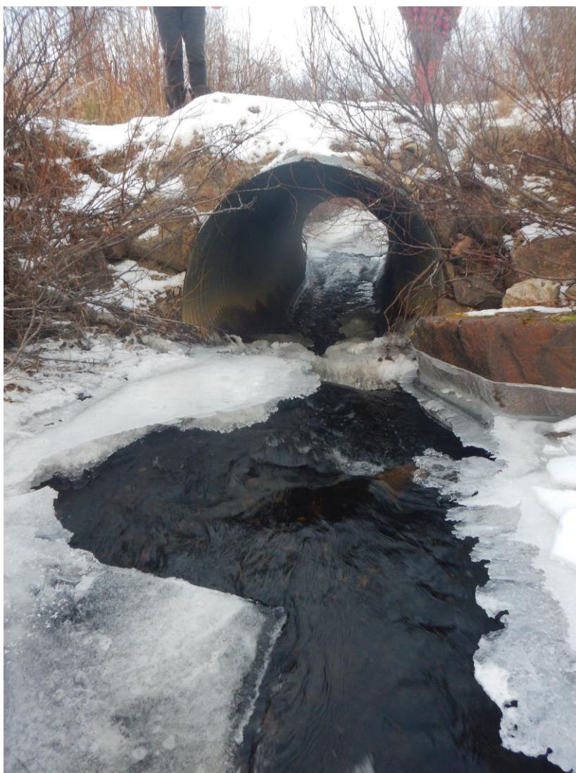
Bilde 7 viser rørkulvert under Ruvvašjohka som utgjør et vandringshinder til gode fiskehabitater oppstrøms.
