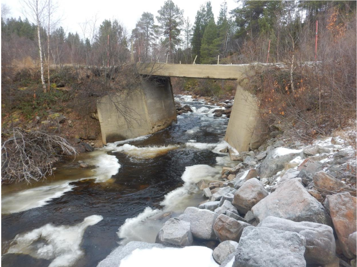
Bilde 1, viser brua med kulvert i Čáhppesjohka som utgjør et vandringshinder.
